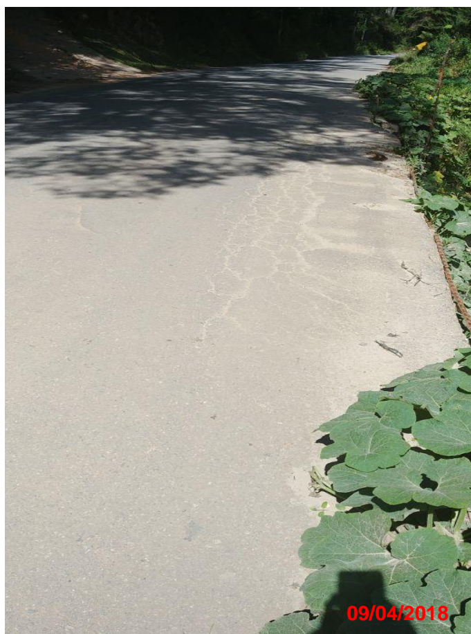
Foto 20 – Pavimento a ser recuperado
