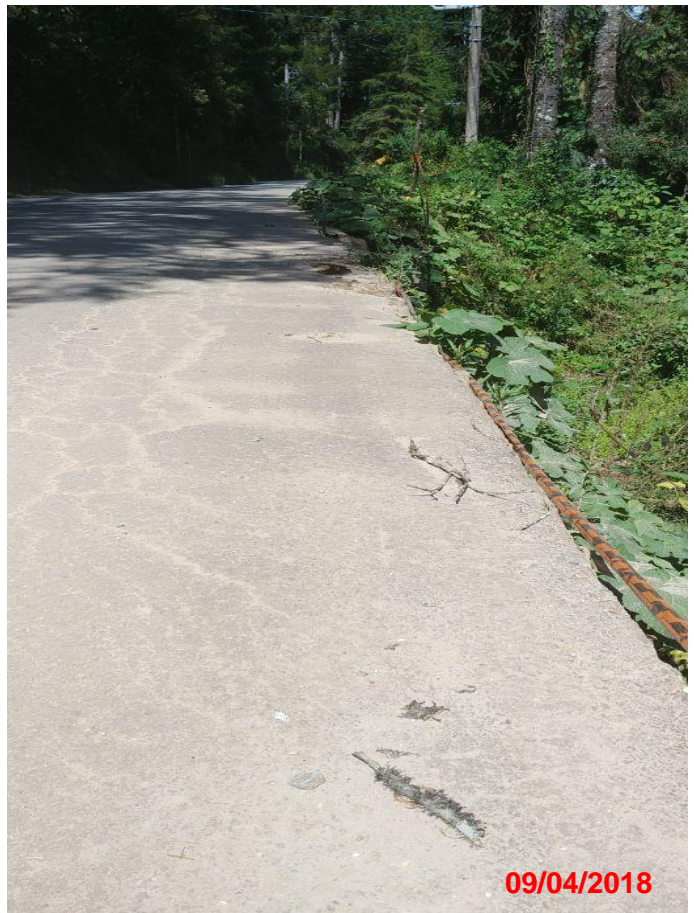
Foto 18 – Pavimento a ser recuperado
