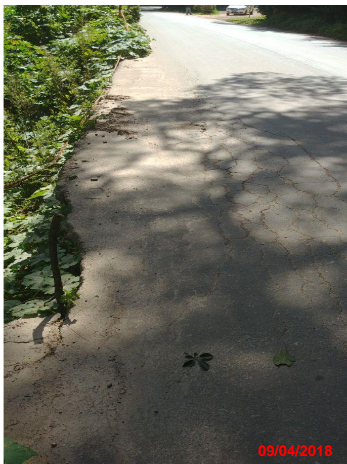
Foto 19 – Pavimento a ser recuperado
