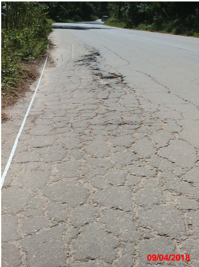
Foto 17 – Pavimento a ser recuperado
