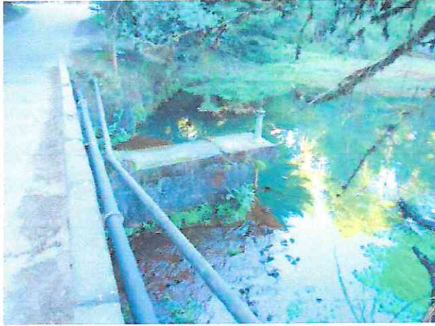
Figura 1 – Vista da seção de saída do reservatório da Vila Inglesa
