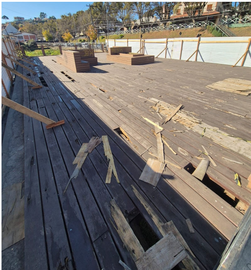
FIGURA 04 – VISÃO INTERNA DA DETERIORAÇÃO DO MADEIRAMENTO
